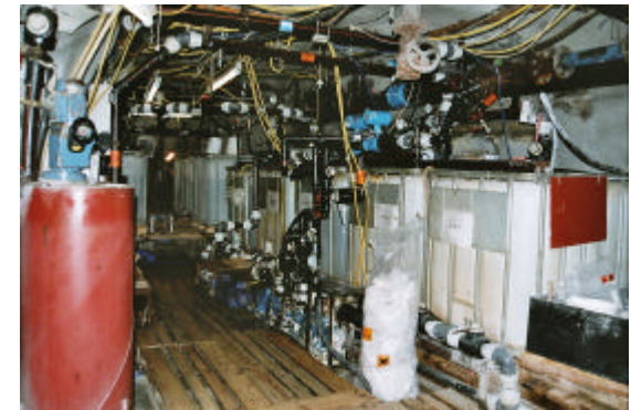
Anlage zur Herstellung \text{BaSO}_4 -bildender Lösungen im Sanierungsbetrieb Königstein der Wismut GmbH
